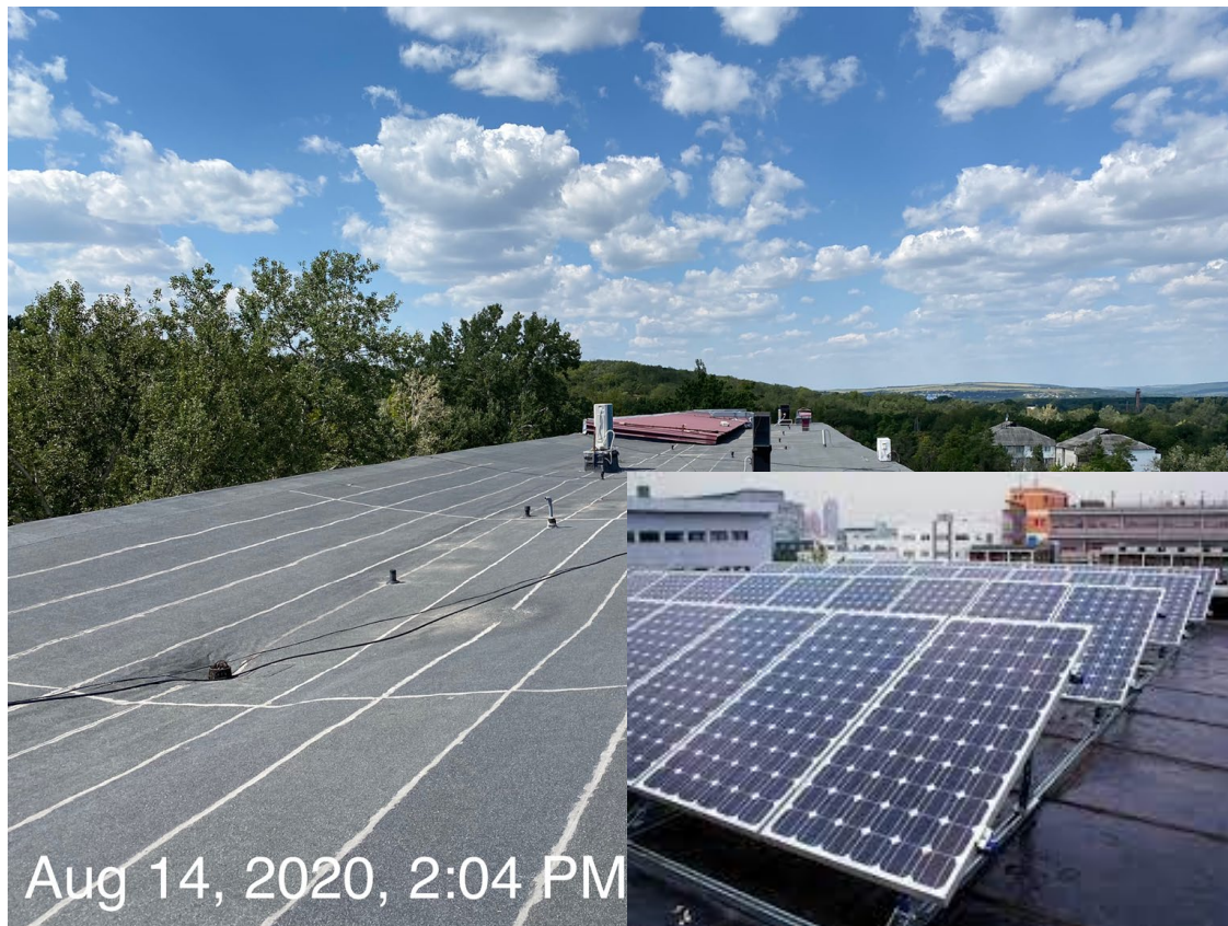
Sanatoriul "Bucuria Sind", Vadul lui Vodă, 10.5kWp
